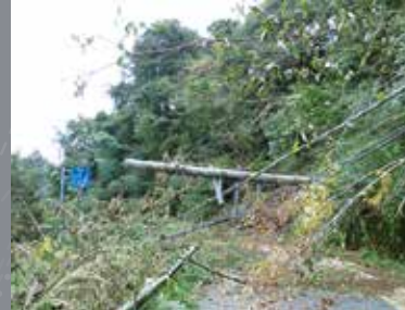
道路沿いの斜面から土砂が流出し電柱が倒壊
