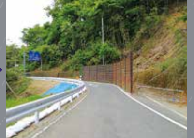
ガードレールおよび防護柵を設置し、応急復旧にて通行を確保
