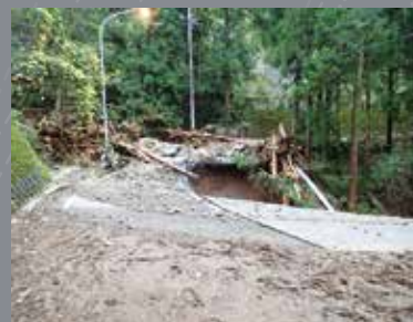
沢からの土石流により道路崩落
