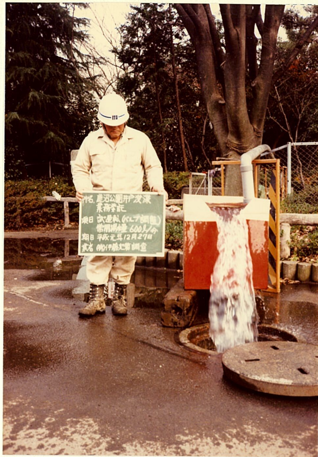
試運転状況 常用揚水量 約600 ℓ /分に調整
