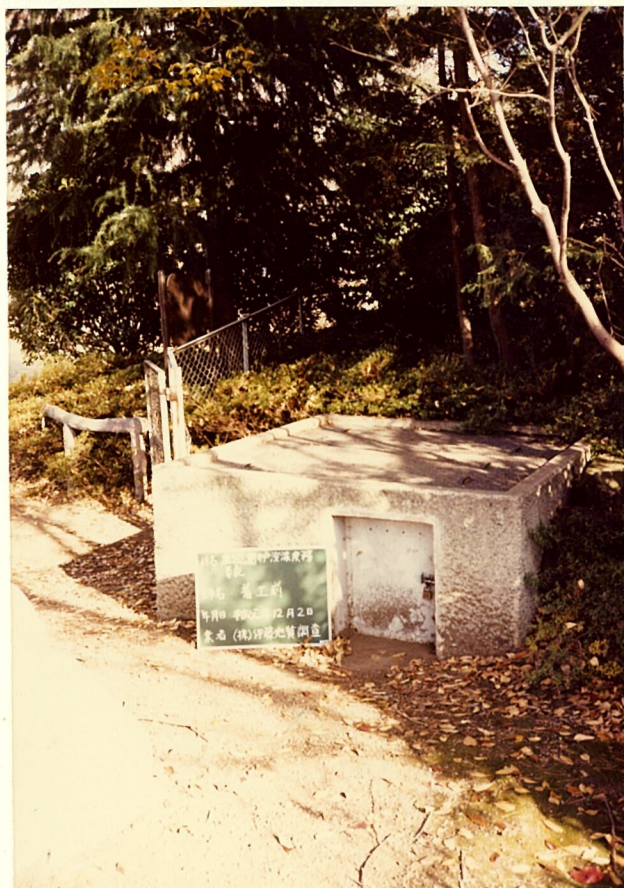
着工前 (制御盤ボックス)
