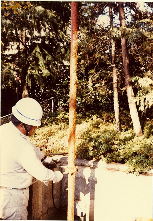
揚水管下部腐蝕状況
