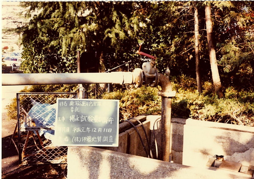
揚水量制御バルブ
