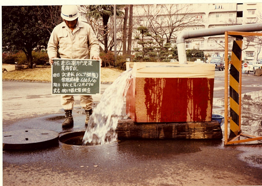
試運転状況 常用揚水量 約600 ℓ /分に調整
