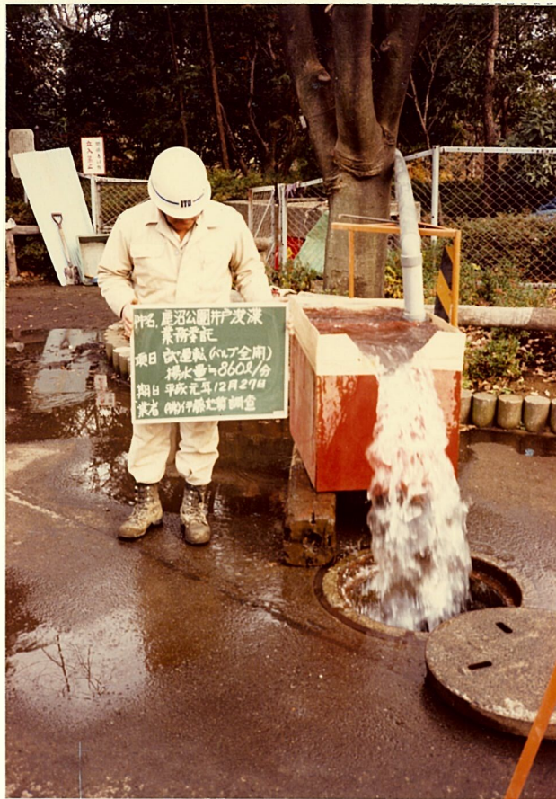
試運転状況 (バルブ全開) 最大揚水量 約860ℓ/分
