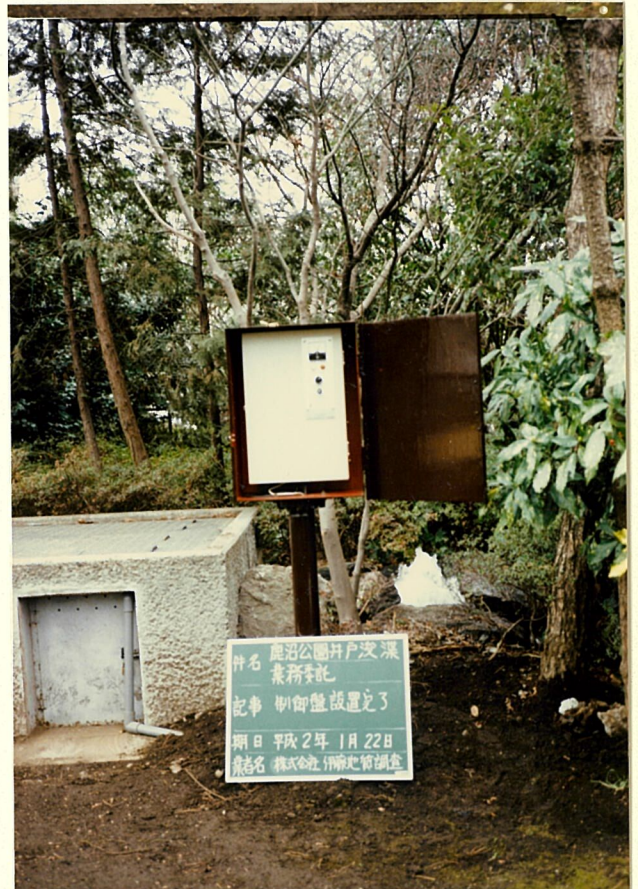
制御盤設置完了
