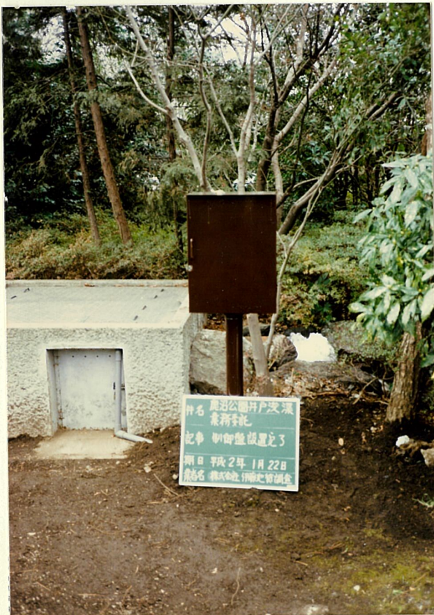
制御盤設置完了
