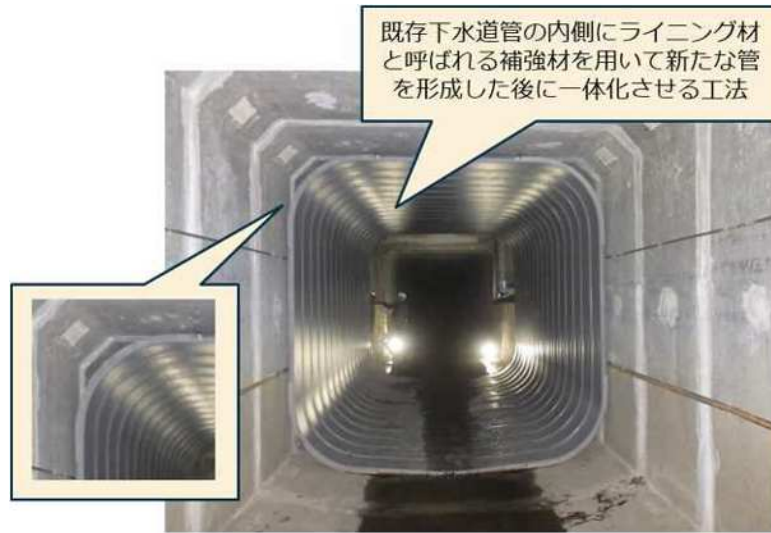
作業途中の製管状態（事故後）
