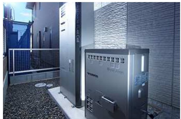
< SOFC 設置例 ( 手前右側 : 発電部、左奥側 : 貯湯部 ) >
