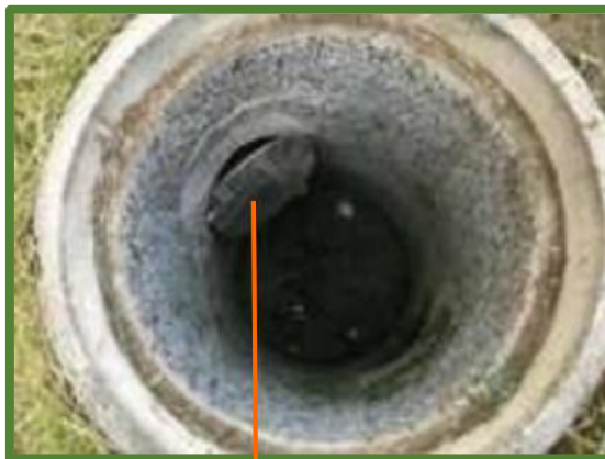
① 排水管接合部の金網
