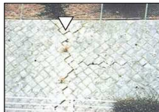
擁壁のひび割れの例
