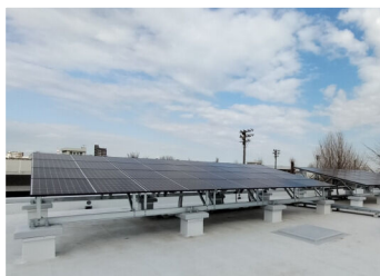
【太陽光発電設備の導入】
