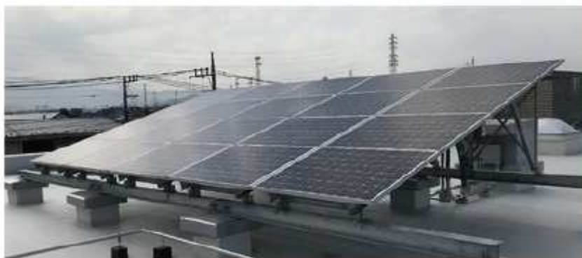
公共施設に設置した太陽光発電設備
