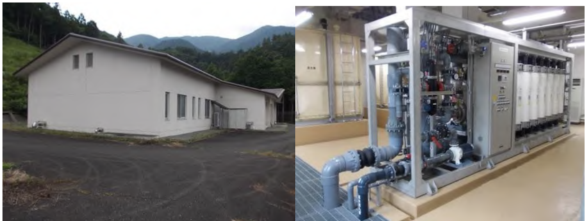
写真 3 青根簡易水道(左:浄水場建屋 右:膜ろ過ユニット)
