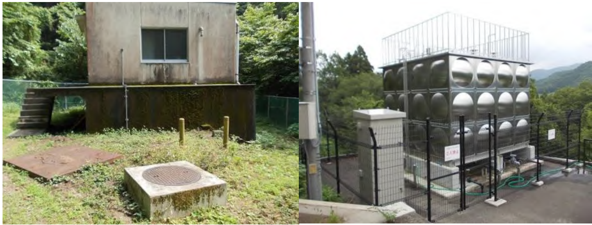
写真 2 牧野中央簡易水道(左:篠原配水池、右:大久和配水池)
