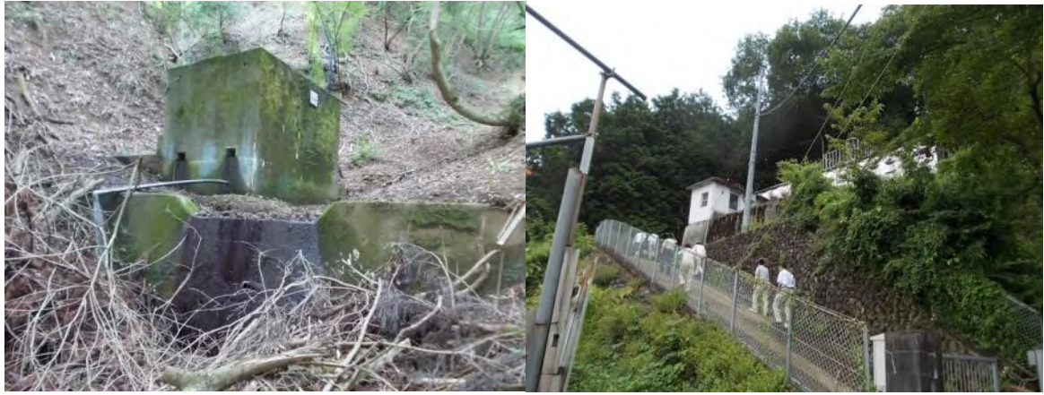
写真 1 葛原簡易水道(左:湧水水源 ポンプ井 右:配水池)
