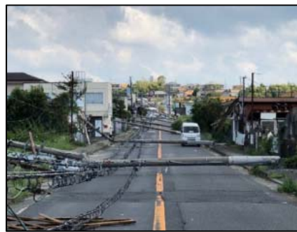
図 1-1 都市の防災性を妨げる電線・電柱
