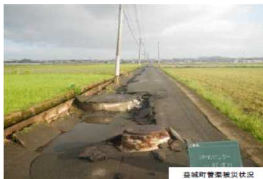
平成28年熊本地震による被害
