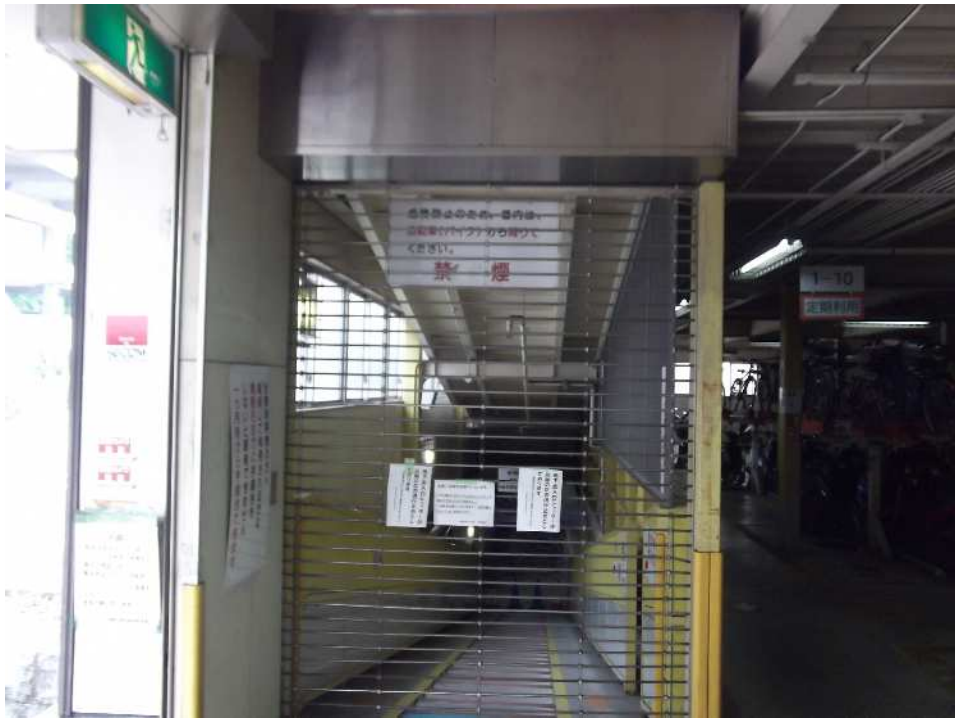
相模大野駅北口自転車駐車場（新館）シャッター破損状況（全景）
