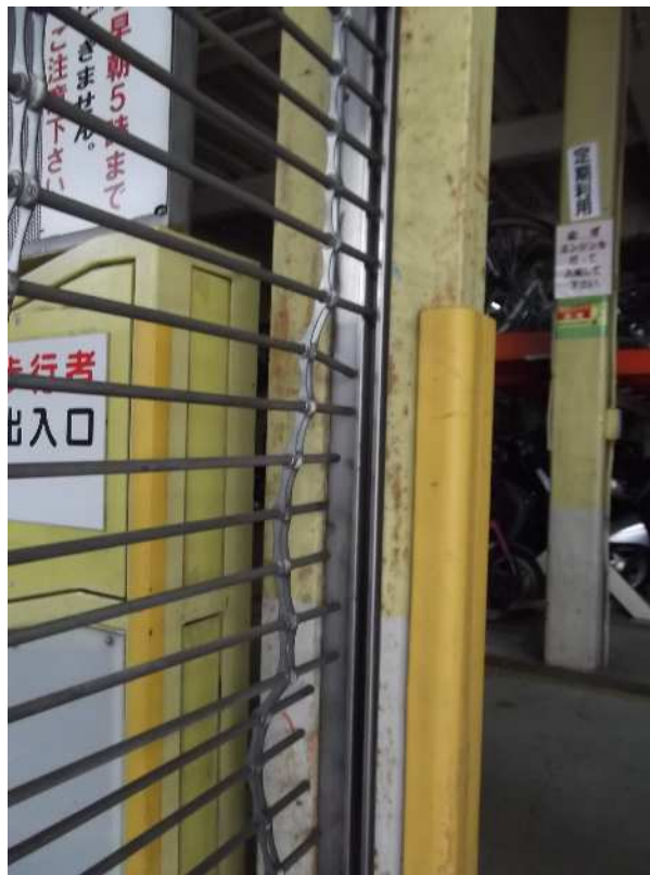
相模大野駅北口自転車駐車場（新館）シャッター破損状況（ガイドレール部）
