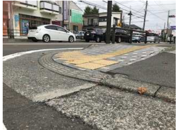
【歩道と車道の傾斜、段差】
