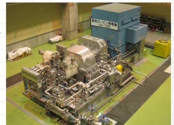
蒸気タービン発電機 (発電)
