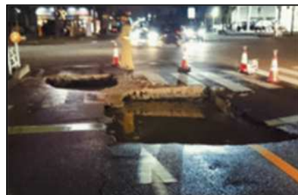
● 管路施設に起因した陥没事故
