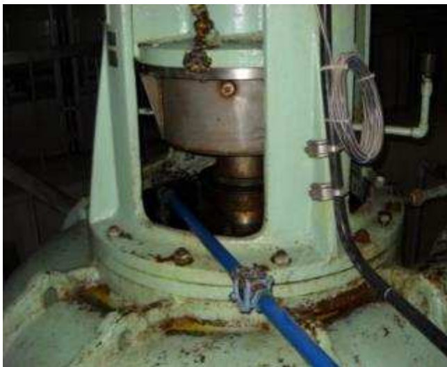
ポンプ本体(内部軸受)の劣化
