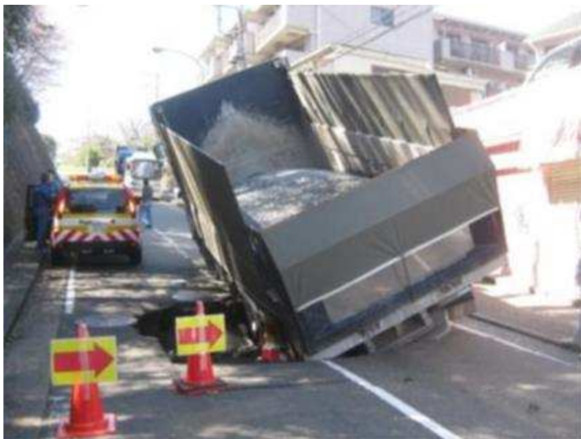
本管(陶管)の破損が原因
