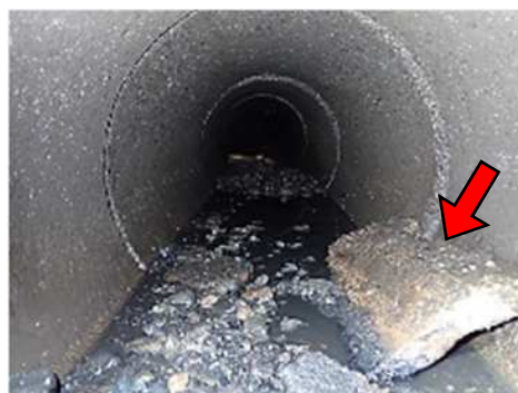
管内に土砂とともに、大きな瓦礫が落ちており、管材の一部が破損した可能性が疑われる。
