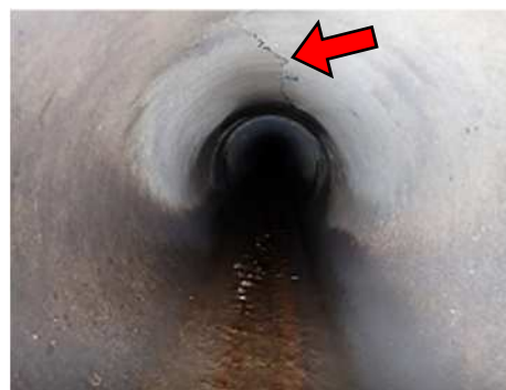
管頂部に軸方向クラックが確認される。
