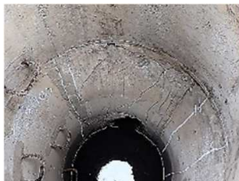
マンホール直壁の全周にわたってクラックが発生
