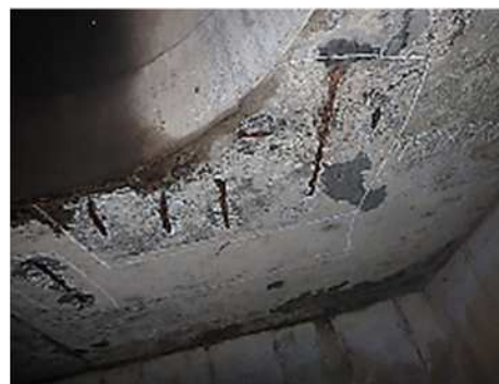
コンクリートの劣化とともに、内部の鉄筋が露出
