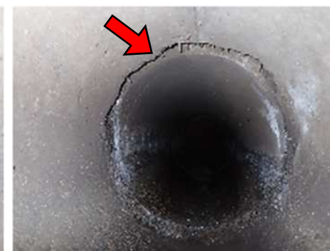
目地部分が破損しており、管ズレが生じている。
