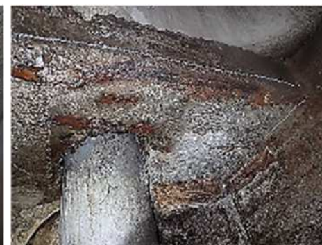
コンクリート内部の鉄筋が露出し、錆が発生
