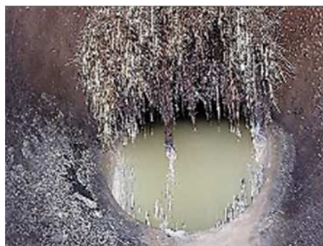
木根が管内の上部に侵入してきており、流下を阻害する恐れがある。
