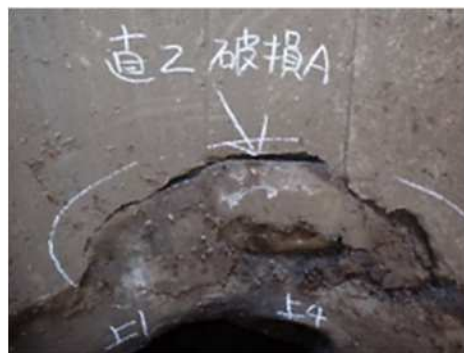
直壁の一部が破損し、コンクリートが大きく剥離
