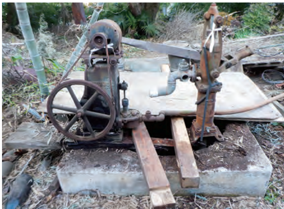
井戸上屋 ポンプ 南西から
