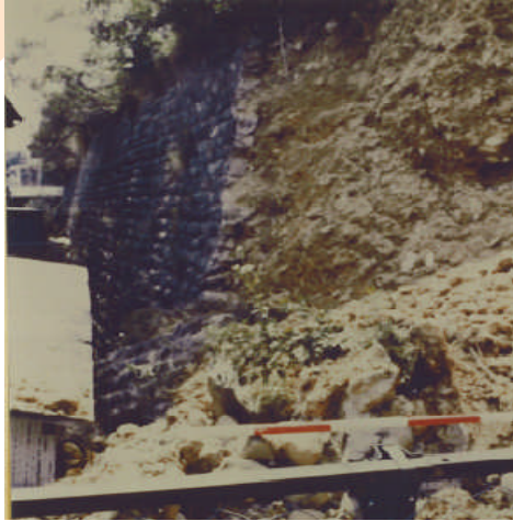
玉石積み擁壁の倒壊
