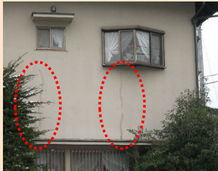
外壁のひび割れ
