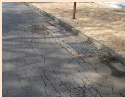
道路の沈下によるひび割れ
