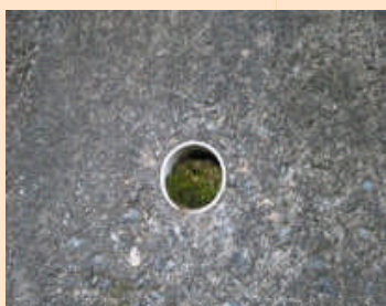
水抜き穴の詰まり
