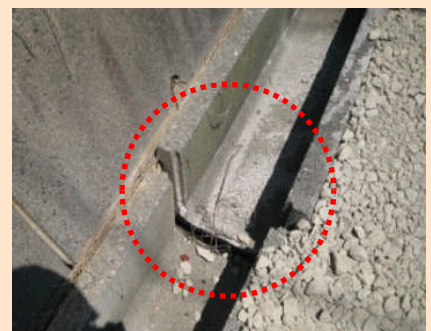
側溝の継目のずれ
