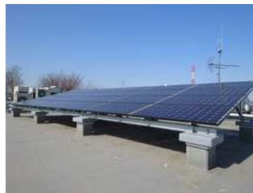
清新公民館に設置した太陽光発電設備
