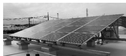
麻溝まちづくりセンター・公民館に設置した太陽光発電設備
