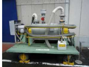
ガス吸収装置
