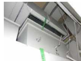
ダクトの変位による フランジの損傷例
