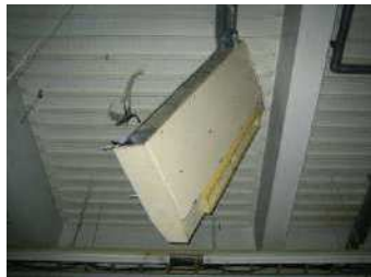
吊りボルトの破断例
