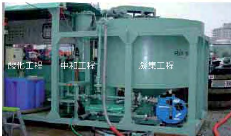
図 8-13 酸化、中和、凝集装置の概況写真
