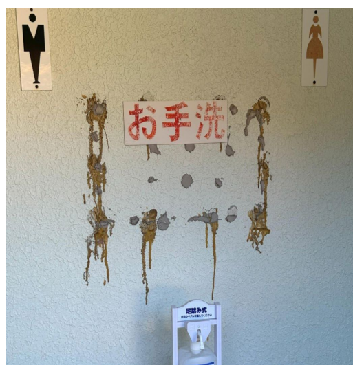
塗装が剥がれている壁
