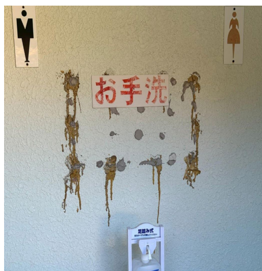
塗装が剥がれている壁
