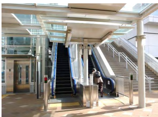
【整備したエスカレーターの様子①】
