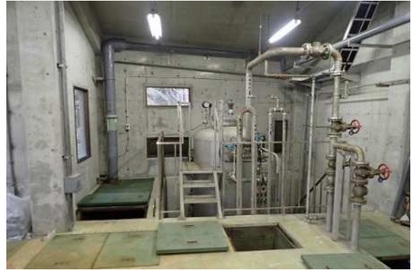
大久和排水処理施設（内部）
