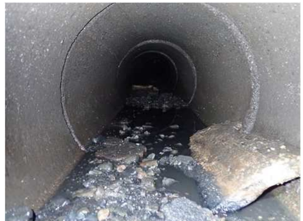
下水道管路内における土砂の堆積状況
