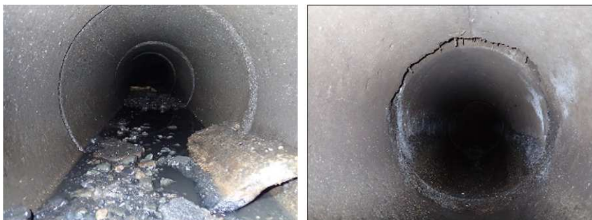
管路施設の老朽化状況
