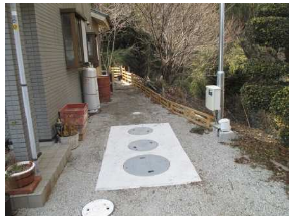
高度処理型浄化槽設置状況
