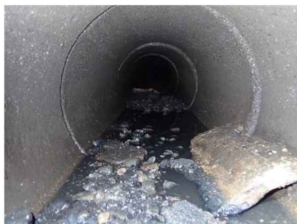
管きよ内における土砂の堆積状況
