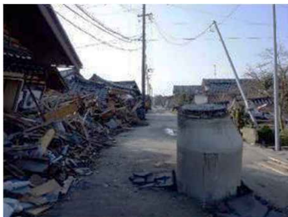
能登半島地震の影響によって隆起したマンホール（石川県珠洲市）
